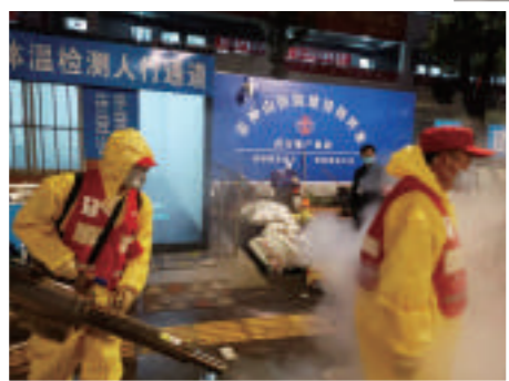
▲2月6日，队员们携带防疫装备和物资进入武汉雷神山医院建设现场，启动防疫消杀行动，保障医院建设和工人人身安全。(红基)
